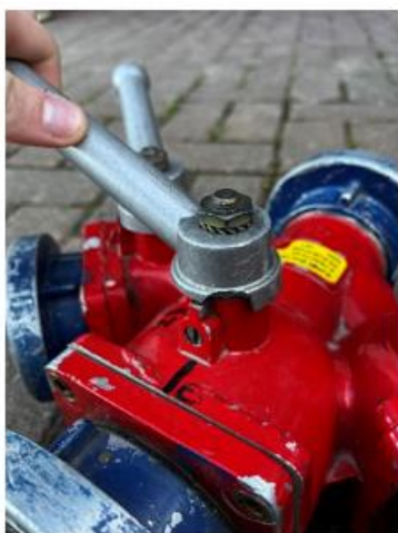
Rys. 1. Uszkodzenie rączki zaworu rozdzielacza
