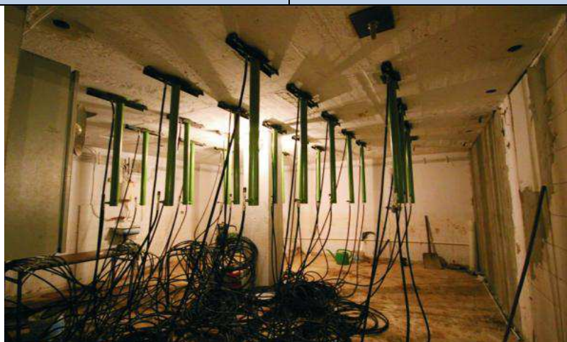
Siłowniki hydrauliczne w trakcie badań
