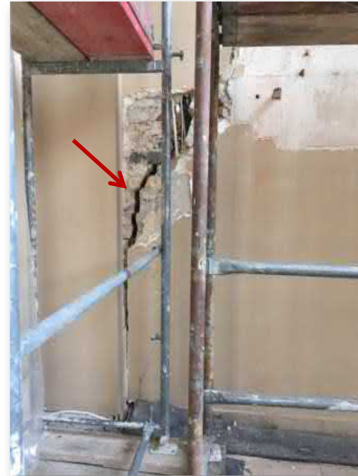
zarysowanie budynku w Rudzie Śląskiej
