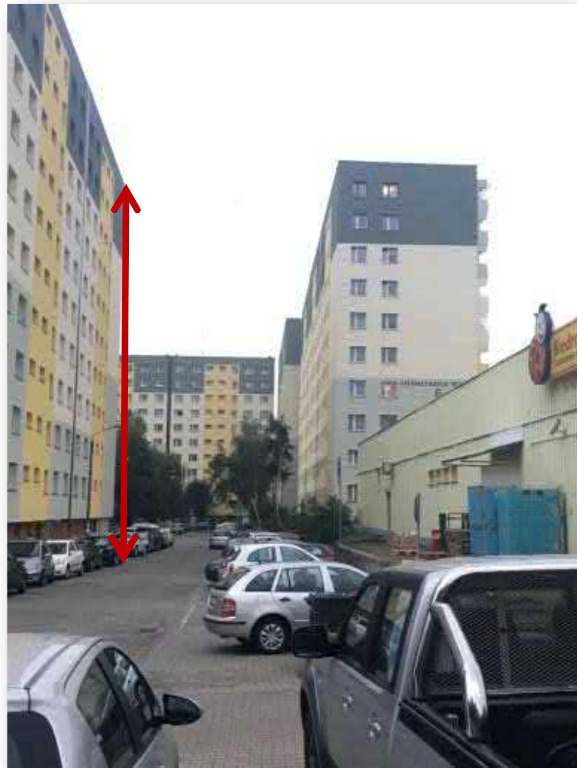
wychylenie budynku w Rudzie Śląskiej
