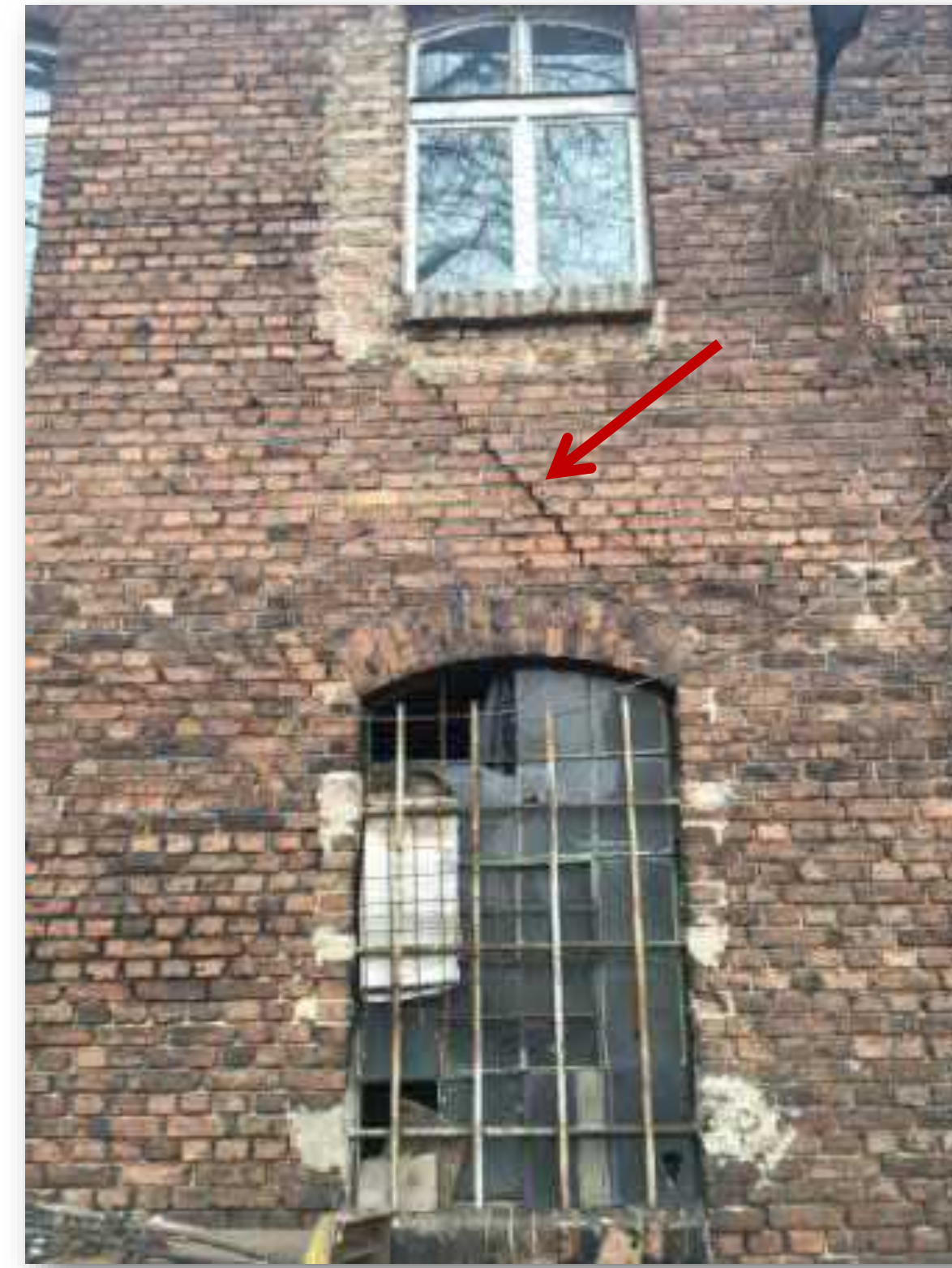
zarysowanie budynku w Rudzie Śląskiej
